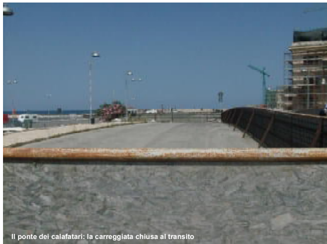
Il ponte dei calafatari: la carreggiata chiusa al transito
